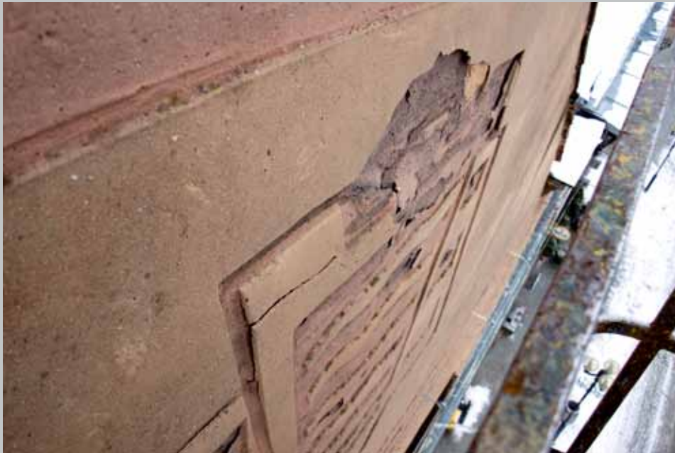
9. Rok 2012. Stan przed pracami konserwatorskimi. Widoczne odspojenia, wybrzuszenia i szczeliny symbolu kina w szczycie elewacji. Fot. D. Pestka-Bajer
