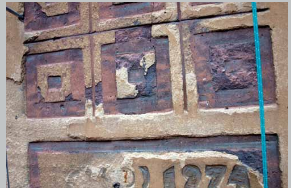
8. Rok 2012. Stan przed pracami konserwatorskimi. Widoczne zniszczenia zaprawy przy inskrypcji z datą. Fot. D. Pestka-Bajer
