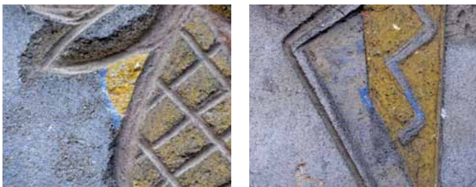
Stare Miasto 17/21 – sgraffita – stan zachowania barwionych wypraw tynkarskich Fot. L. Wawrykiewicz, 2017
