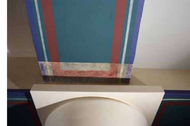
Podciąg Holu Głównego. Rekonstrukcja wymalowania pasowego oraz pozostawiony „świadek” z wykonanym retuszem fragmentu oryginalnego.
